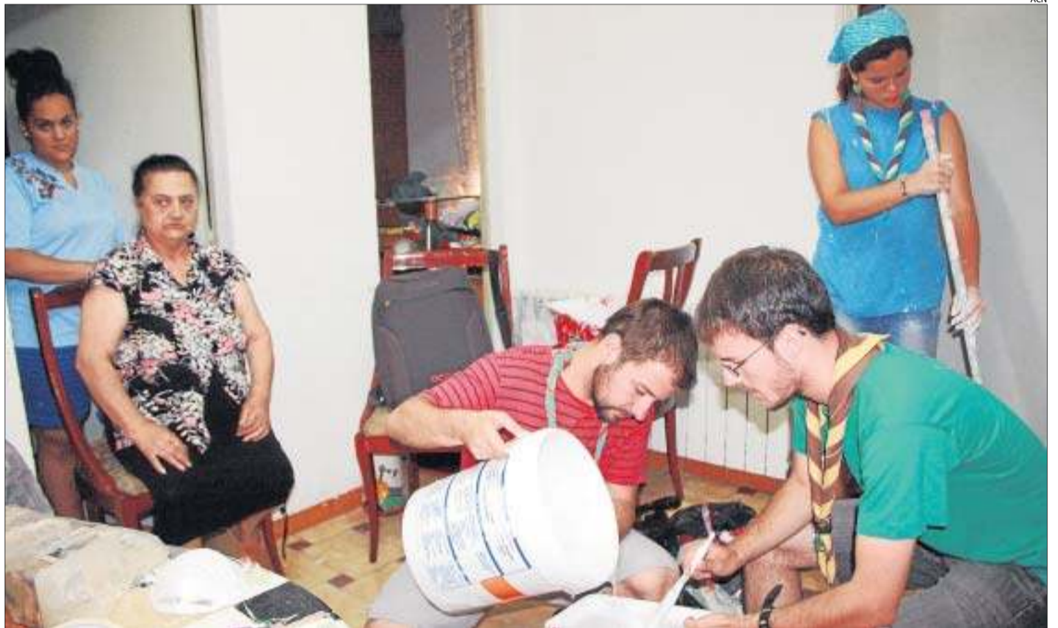
Un grup d'escoltes, preparant la pintura per a les parets d'un dels habitatges que es rehabiliten.
